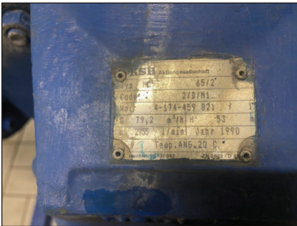
Bild 10, 11 und 12: Ansicht des Grundwasserpumpwerks am Fassungsbereich Quelle 1 mit Förderpumpen (2 Stück Typ KSB MOVI 65/2D) und UV-Anlage Fa. Wedeco
