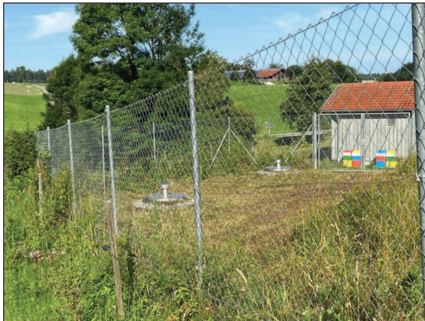
Bild 2: Blick auf Quellsammelschacht Quelle 1 und Hauptquellsammelschacht Quelle 1, 3 und 4 mit Umzäunung
