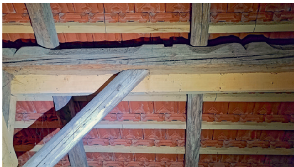
Abb. 11: Zweitverwendung der historischen Fußpfette, Zustand 2013.
