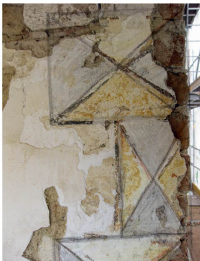
Abb. 26: Bossenmalerei an der Nordwestecke des Hauses und darübergelegte Umzeichnung, 2013.
